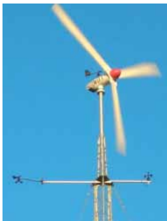
Le pale sono lunghe tra i 3 e i 9 metri e il palo di sostegno è compreso tra i 10 e i 20 metri
