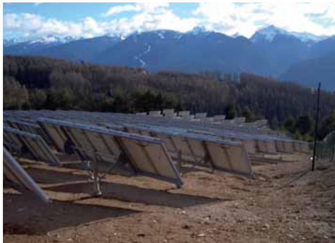
I tremila pannelli dell'impianto di Carano producono oltre seicentomila kilowattora all'anno. Gli introiti lordi coprono il mutuo decennale e i costi di gestione
