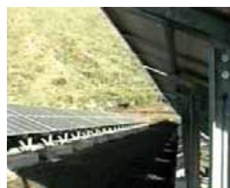
La centrale fotovoltaica di Ginostra attivata da Enel nel 2004
