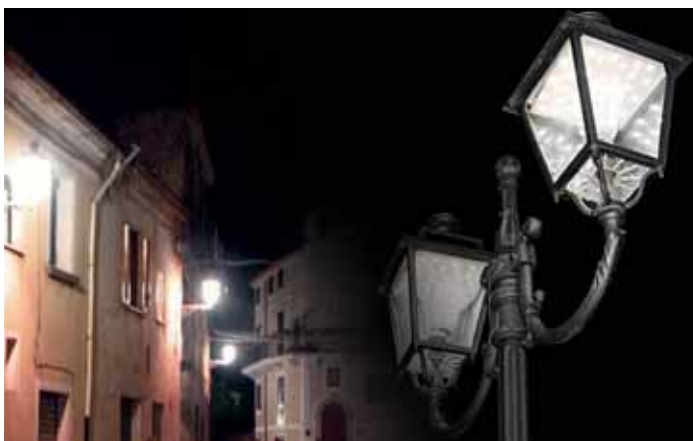
I lampioni di Torraca funzionano a Led e consentono di risparmiare energia fino al 70%
