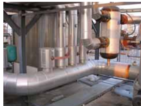
Il sistema di recupero calore della tipografia Canale
